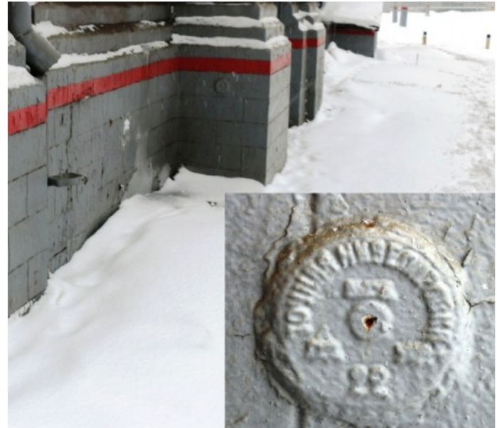
Рис. 9. Нивелирная марка ВГУ 1921 года в цоколе здания главного распределительного пункта станции Москва Рогожская. Фото автора, январь 2019 года
